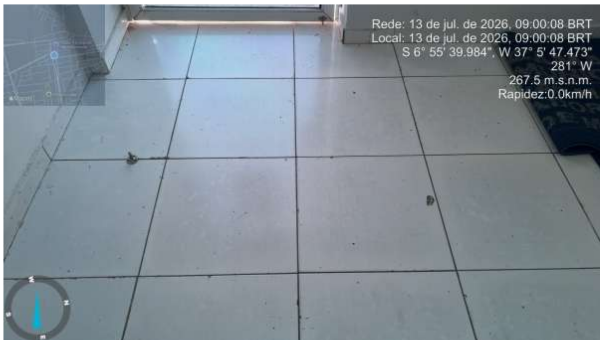
Figura 1 - RECEPÇÃO COM REVESTIMENTO COM DESGASTADO.
