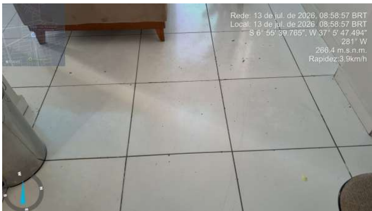
Figura 2 - RECEPÇÃO COM REVESTIMENTO COM DESGASTADO.
