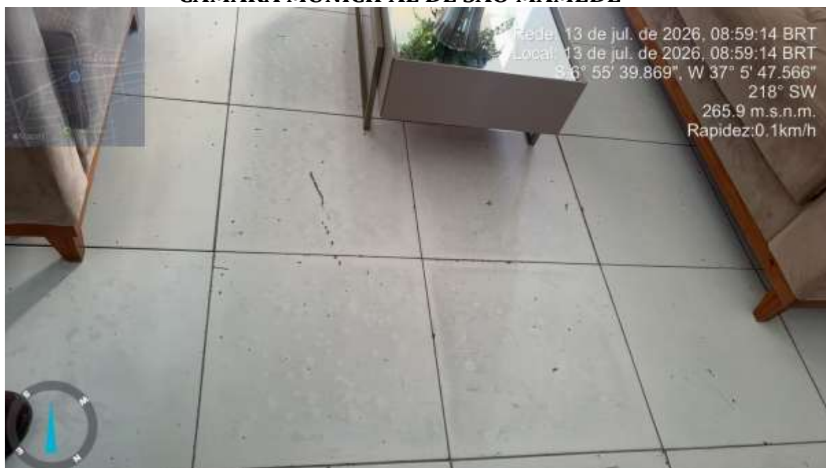
Figura 3 - RECEPÇÃO COM REVESTIMENTO COM DESGASTADO.
