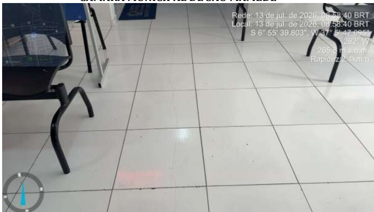
Figura 5 - PLENÁRIO COM DESGASTE E SINAIS DE AFUNDAMENTO.
