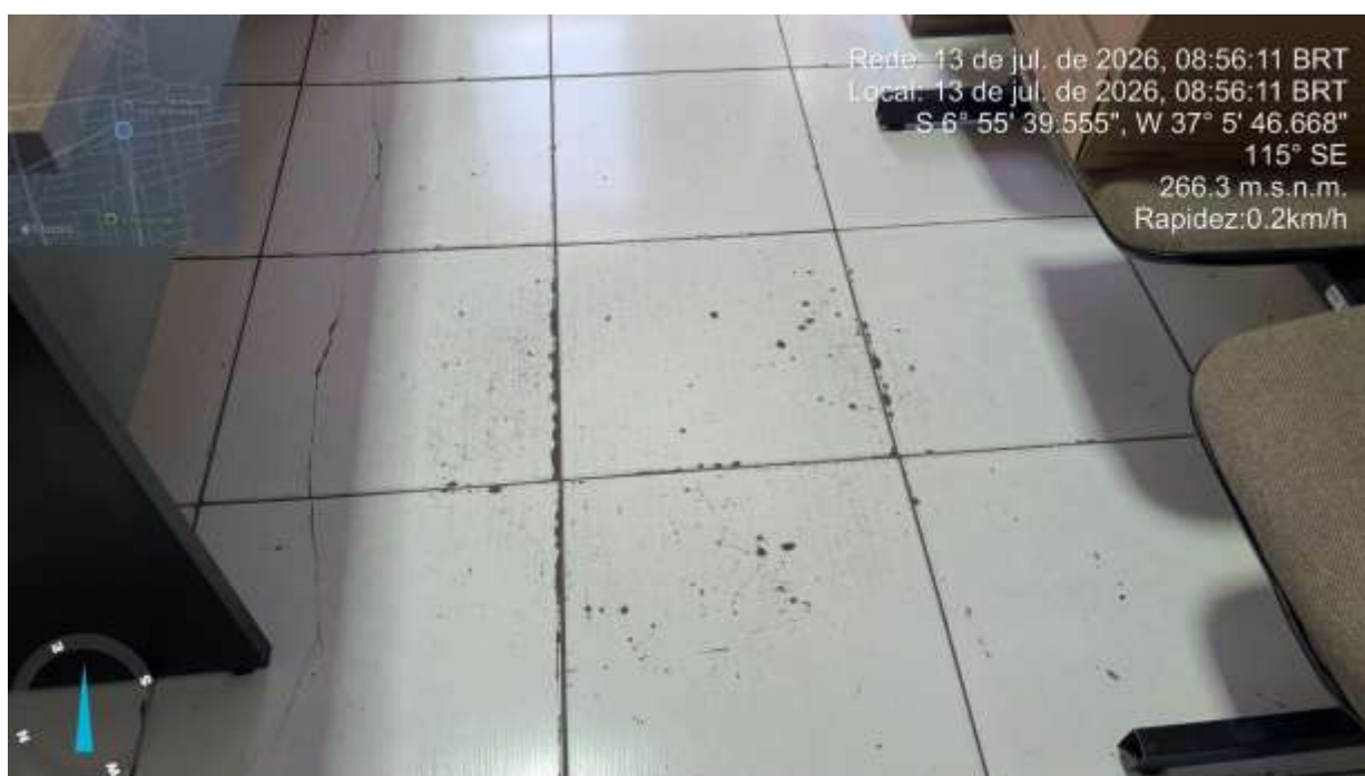
Figura 10 - SALA DA ADMINISTRAÇÃO COM REVESTIMENTO DESGASTADO E SINAIS DE AFUNDAMENTO.
