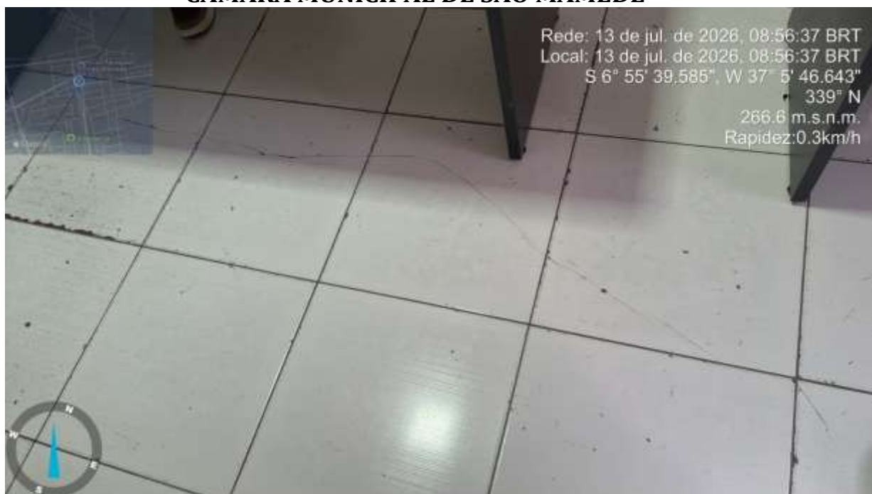
Figura 9 - SALA DA ADMINISTRAÇÃO COM REVESTIMENTO DESGASTADO E SINAIS DE AFUNDAMENTO.
