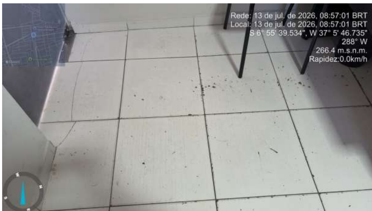
Figura 8 - SALA DA ADMINISTRAÇÃO COM REVESTIMENTO DESGASTADO E SINAIS DE AFUNDAMENTO.
