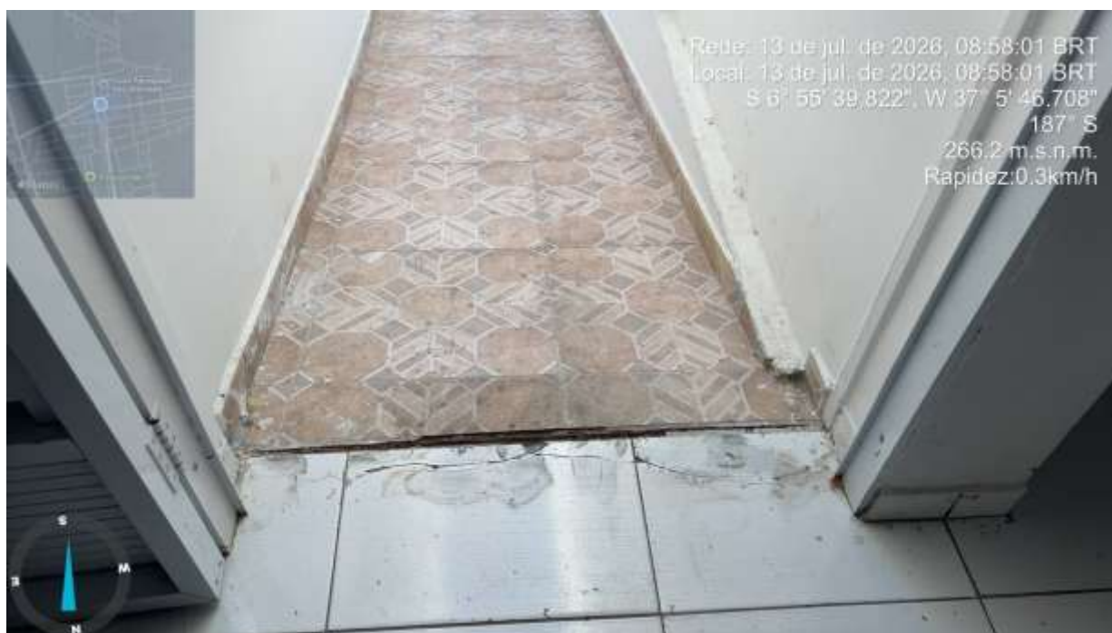
Figura 6 - ENTRADA DE SERVIÇO COM REVESTIMENTO QUEBRADO.
